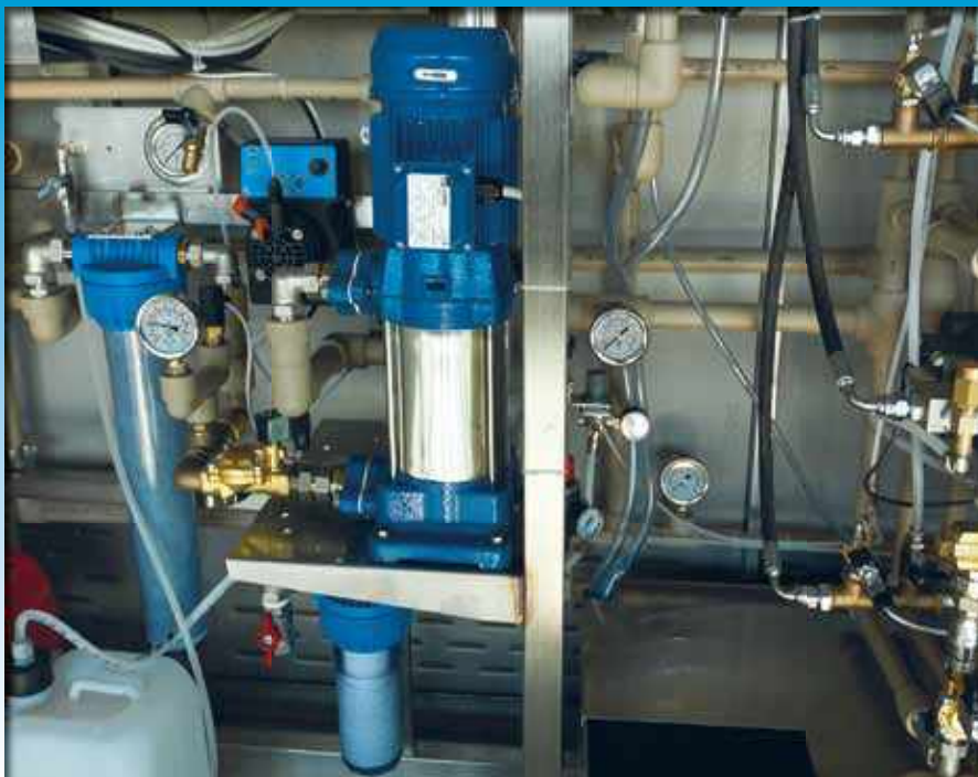
Particolare interno filtri e pompa produzione osmosi Filters and osmosis pump
