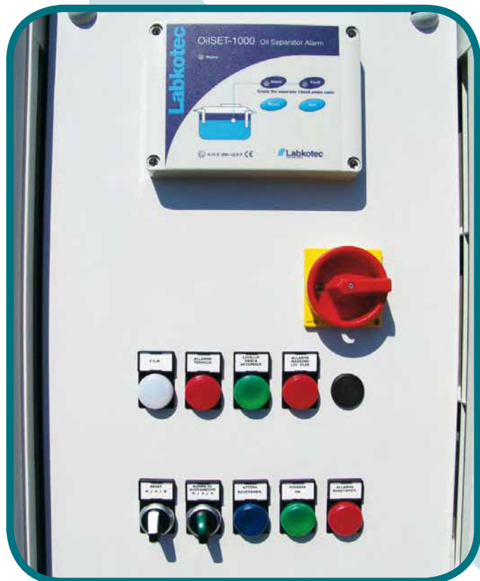
Dettaglio del quadro elettrico con centralina oli Detail of electrical board with oil probe controller
