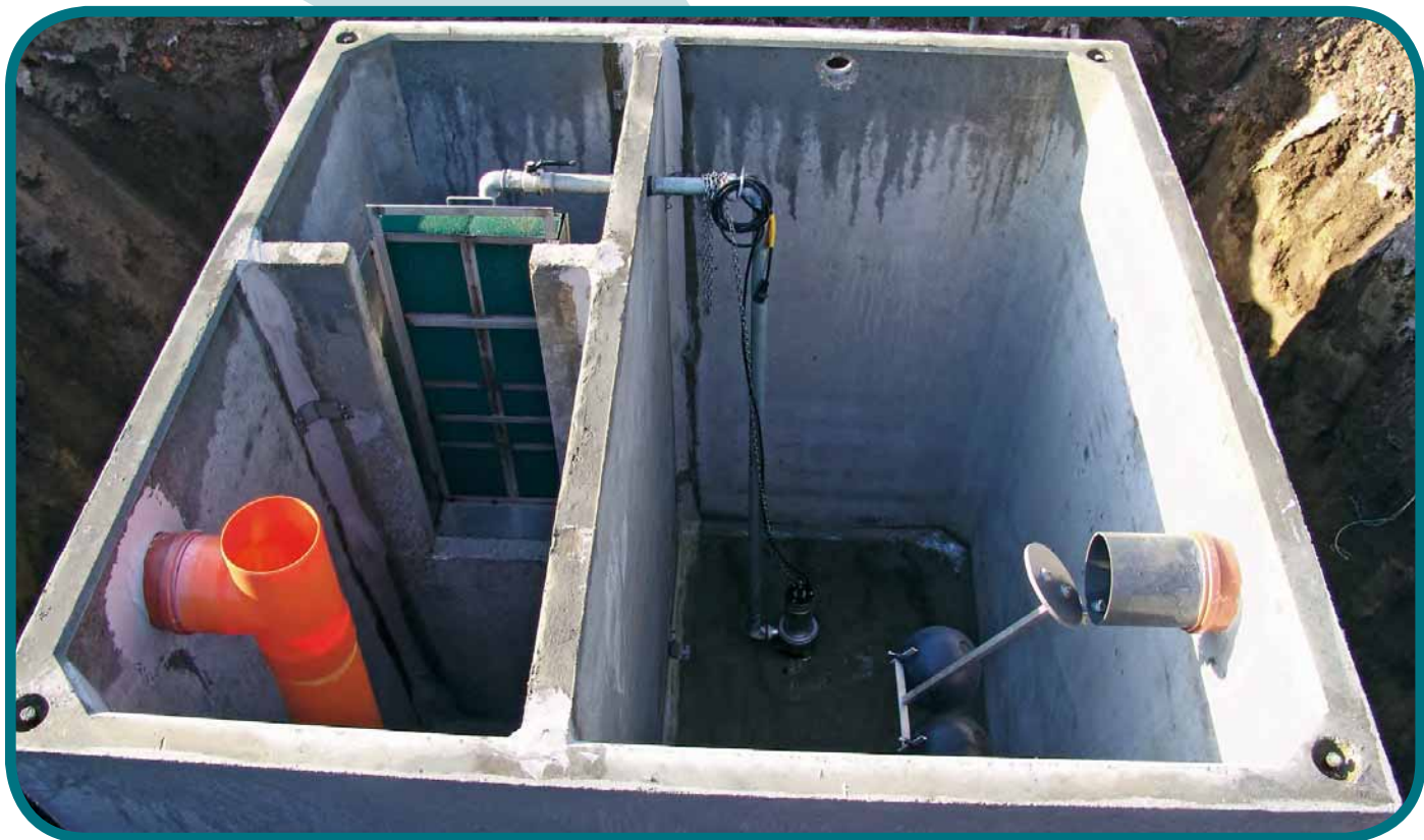
Vista parte interrata impianto prima pioggia - View of underground first rain plant
