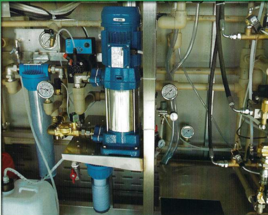
Particolare interno filtri e pompa produzione osmosi Filters and osmosis pump
